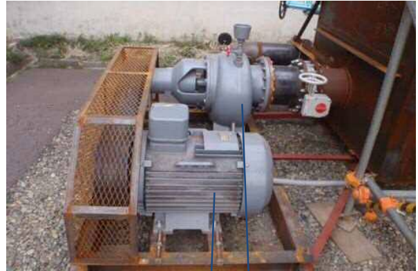
45KW6P 電動機 インバータによる 変速運転
