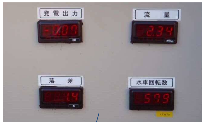
データ表示盤 ・発電出力 ・流量 ・落差 ・水車回転数
